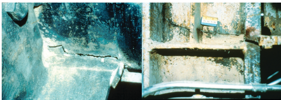
a) Fractura en la junta viga-columna
